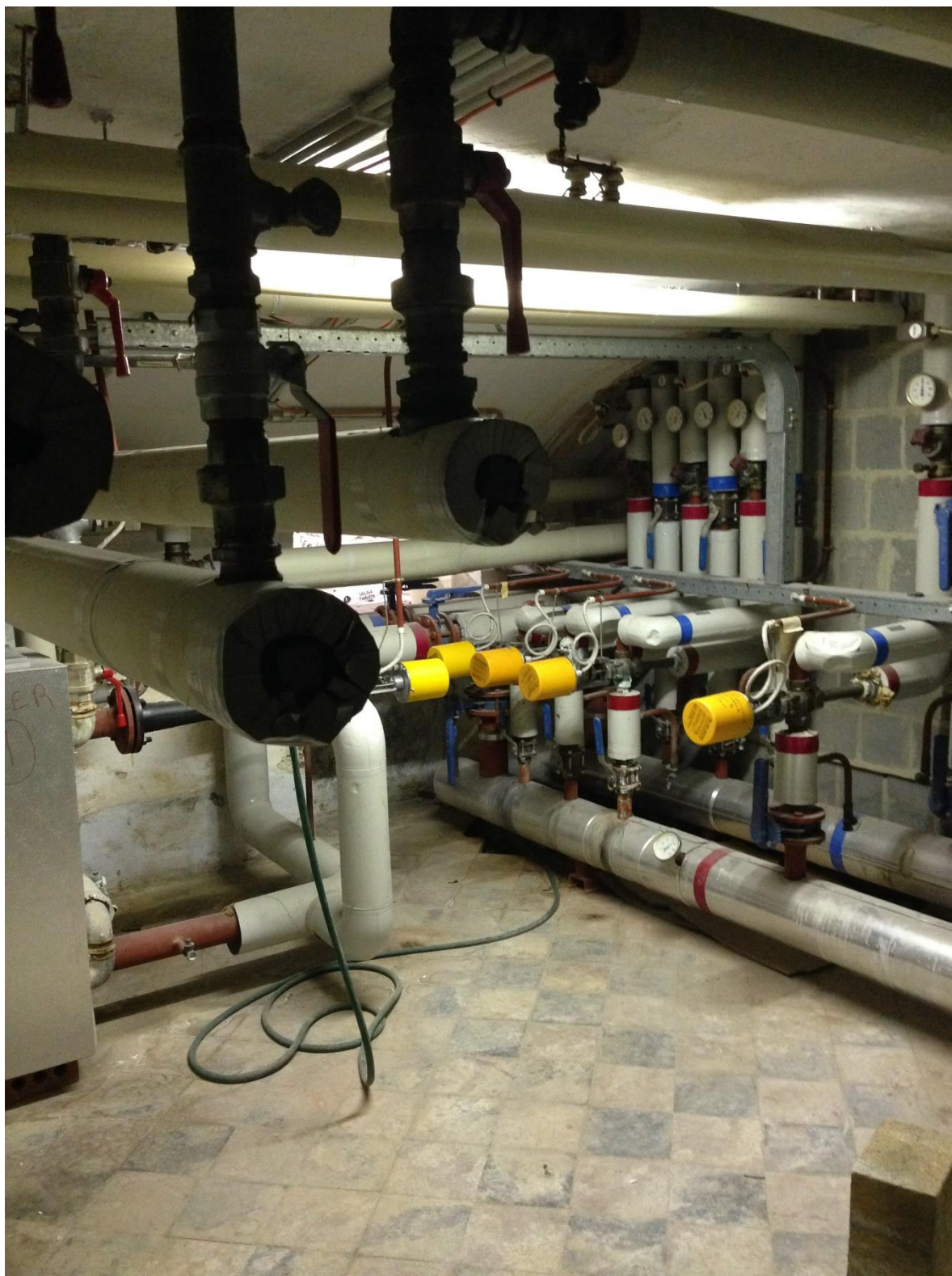
fig. 13: De verwarmingsinstallatie in kelderruimte B5.
