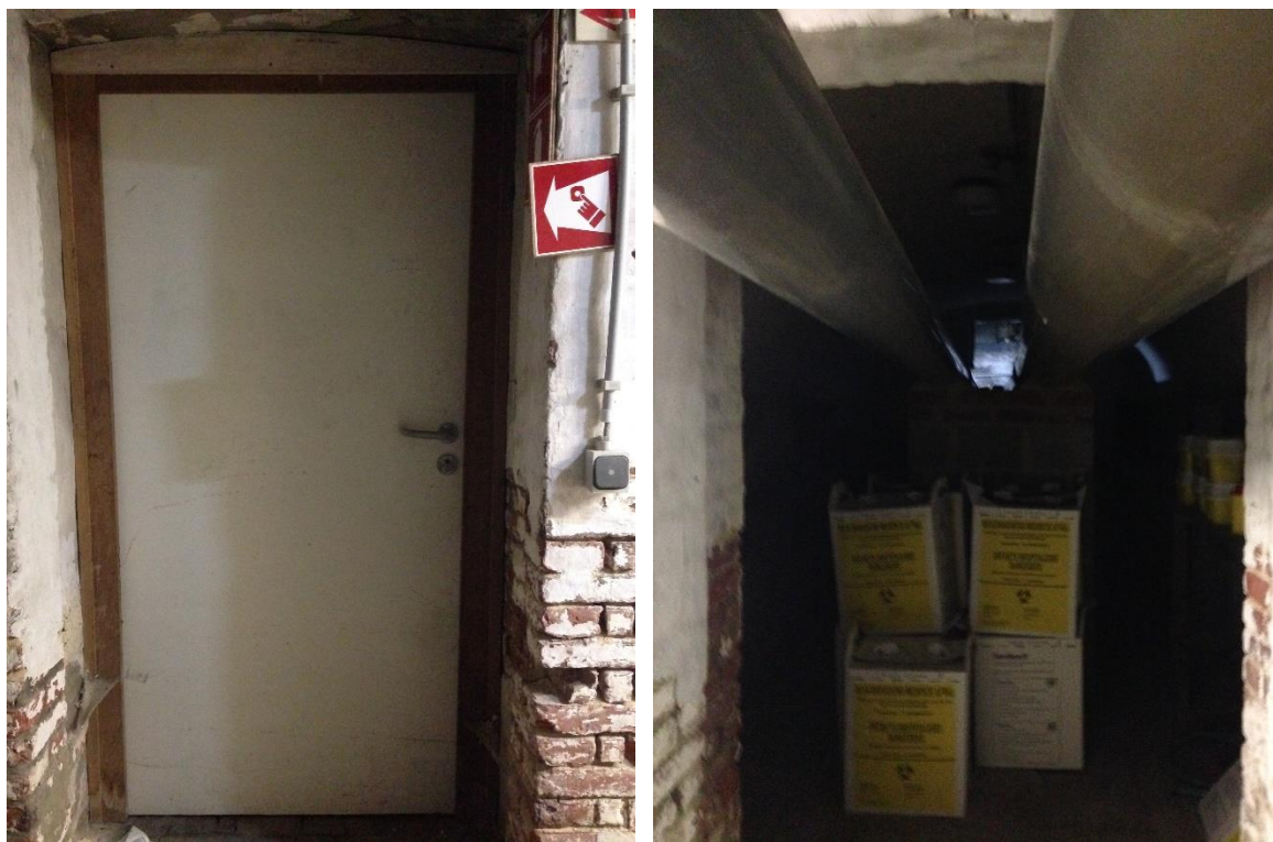
fig. 22: Links: De gesloten branddeur van kelderruimte D3.
