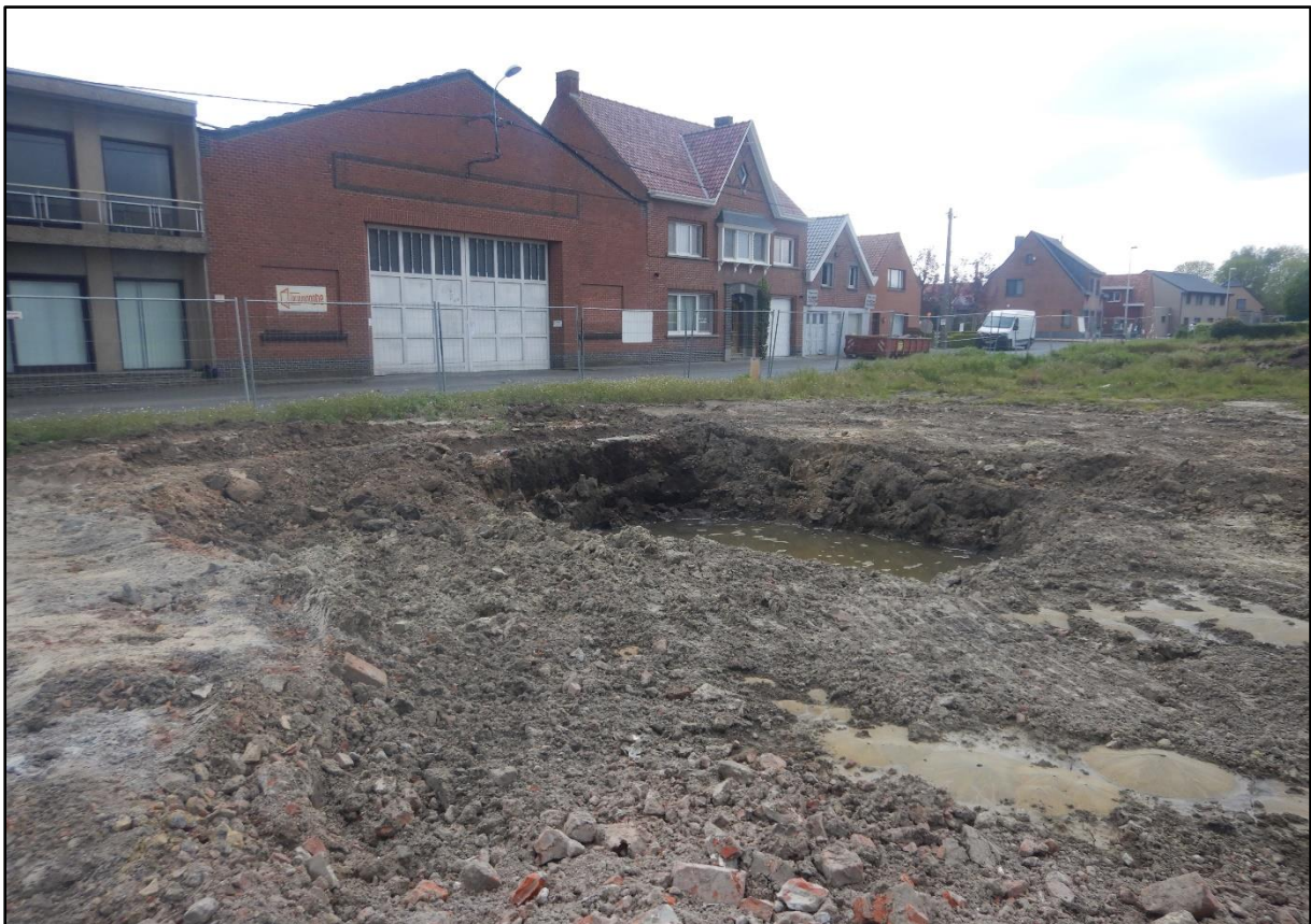
Figuur 3 Zicht op de uitgebroken kelder ter hoogte van Snekpestraat 54.
