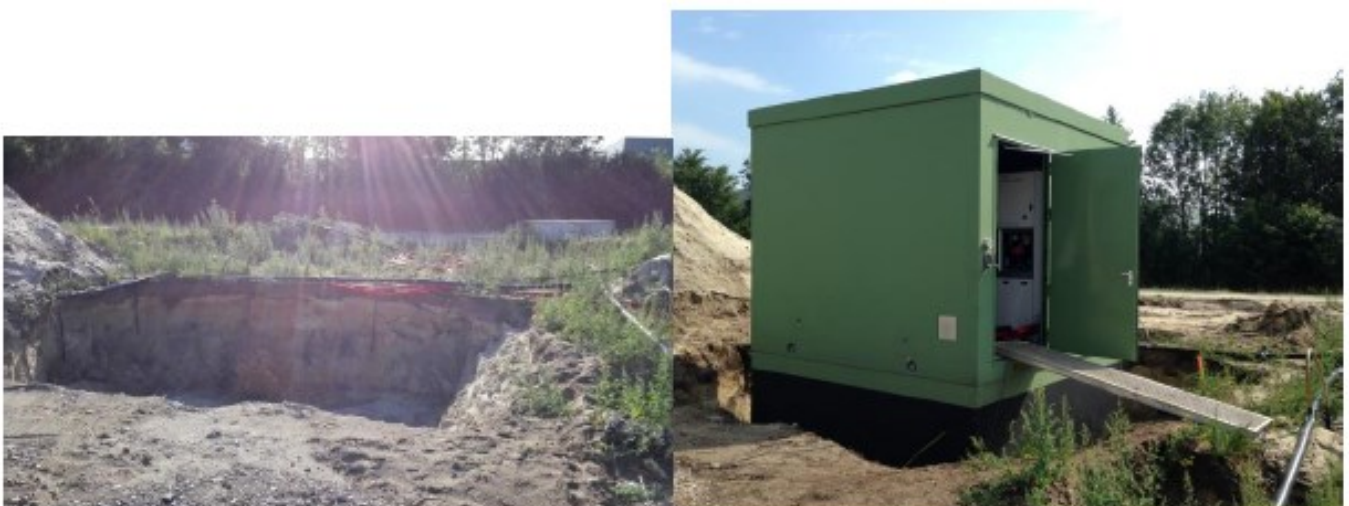
Figuur 6: Voorbeeld van netstation en elektriciteitscabine.
