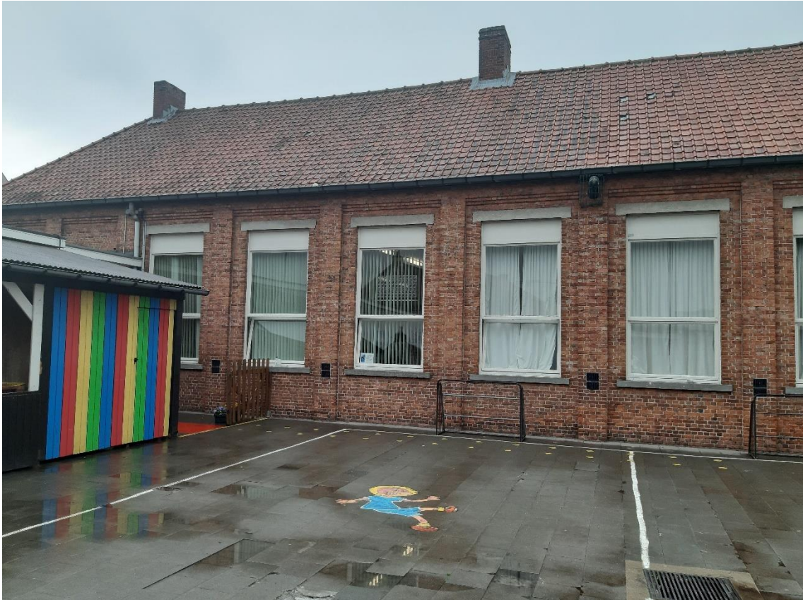
Figuur 5: Te slopen bebouwing gezien vanuit het binnengebied (gebouwen A (links) en B(rechts))
