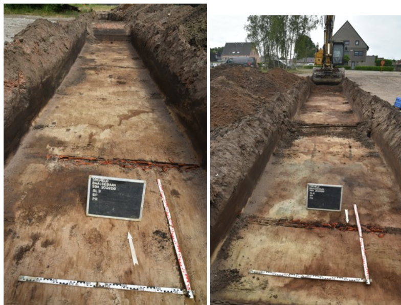
Fig. 3.24: Overzichtsfoto's van sleuven 3 en 4 met hierin een duidelijk zicht op de dwars oranje gekleurde drainagebuizen die over het volledige terrein ook in de andere sleuven werden aangetroffen en gelinkt kunnen worden aan vroegere landbouwactiviteiten
