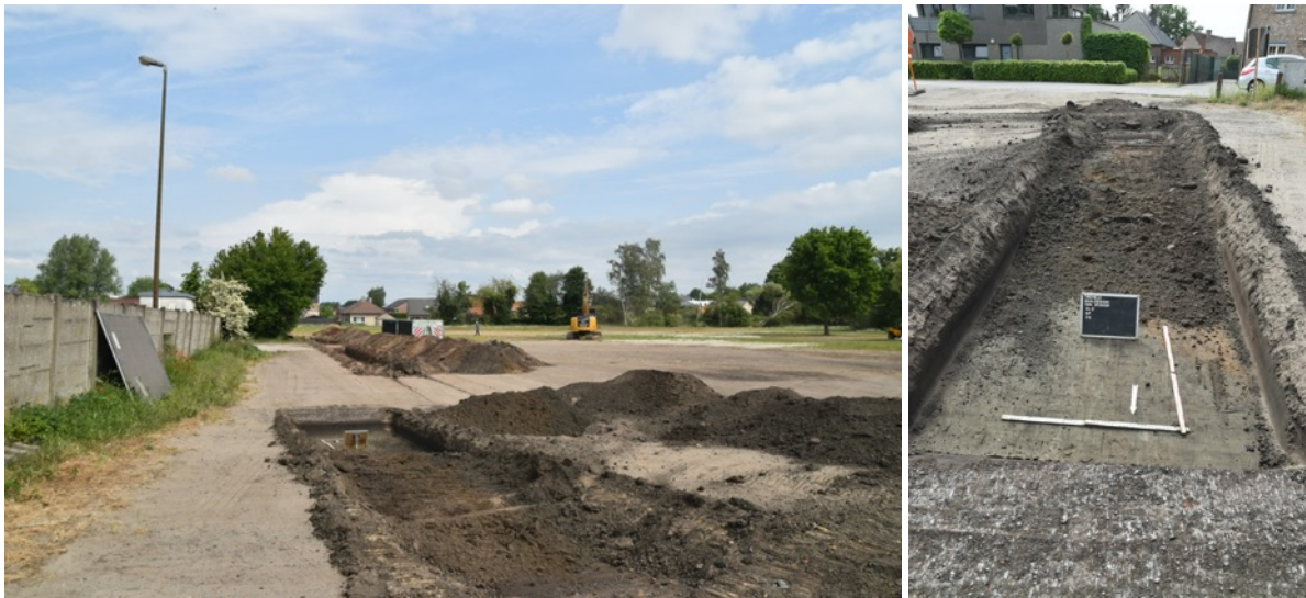
Fig. 3.11: Zicht op sleuf 3 in het zuiden van het terrein. Deze sleuf werd hier onderbroken vanwege een bestaande leiding op het KLIP-plan. De sleuf zelf werd niet verder aangelegd vanwege vervuiling (asbest en een mazoutgeur).
