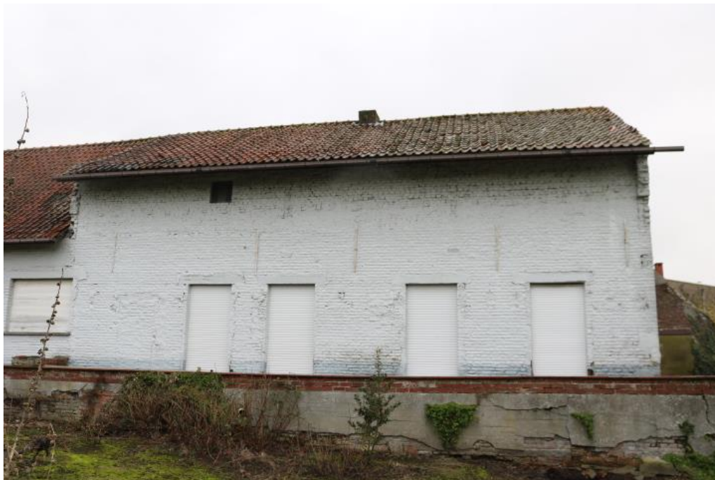
Vleugel 1 boerenwoning verankerde achtergevel; 18 de eeuwse muuropeningen; sporen van ophoging van de dakconstructie (19 de -20 ste eeuw?) en afbraak van aanbouw aan zuidelijke hoek.
