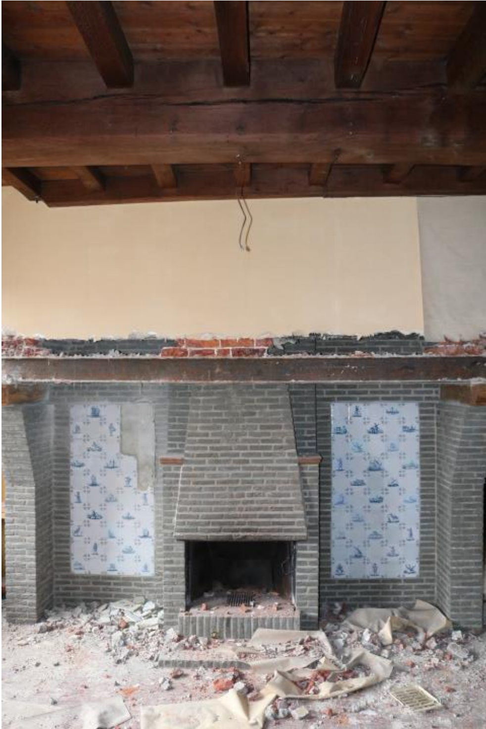
Vleugel 1 : 19 de en 20 ste eeuwse reconstructie met ondermeer stalen profiel en moderne gevelstenen.
