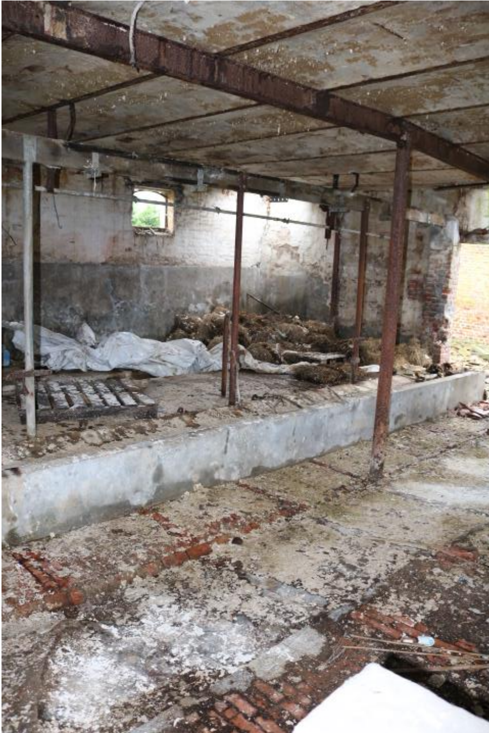
Vleugel 2 : inrichting als stallen. Inrichting na de 19 de eeuw gezien de bakstenen gewelven op stalen I-profiel.
