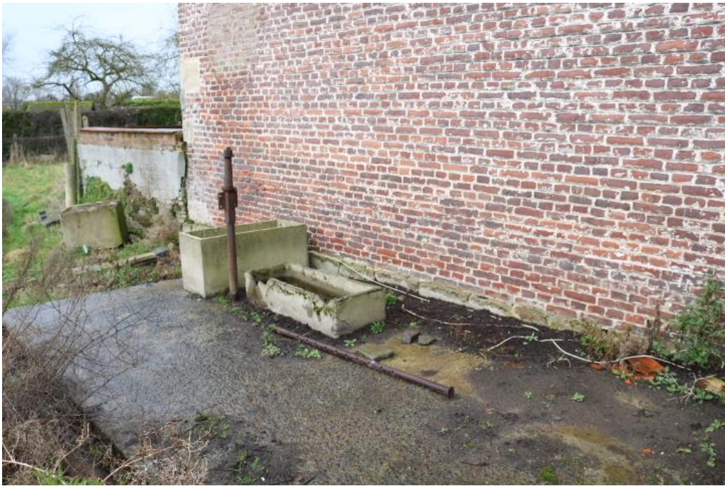
Vleugel 1 : boerenwoning zuidwestelijke zijgevel met spolia uit zandsteen in fundering; negblokken in zandsteen op de hoeken; vermoedelijk 17 de eeuws metselwerk in kruisverband
