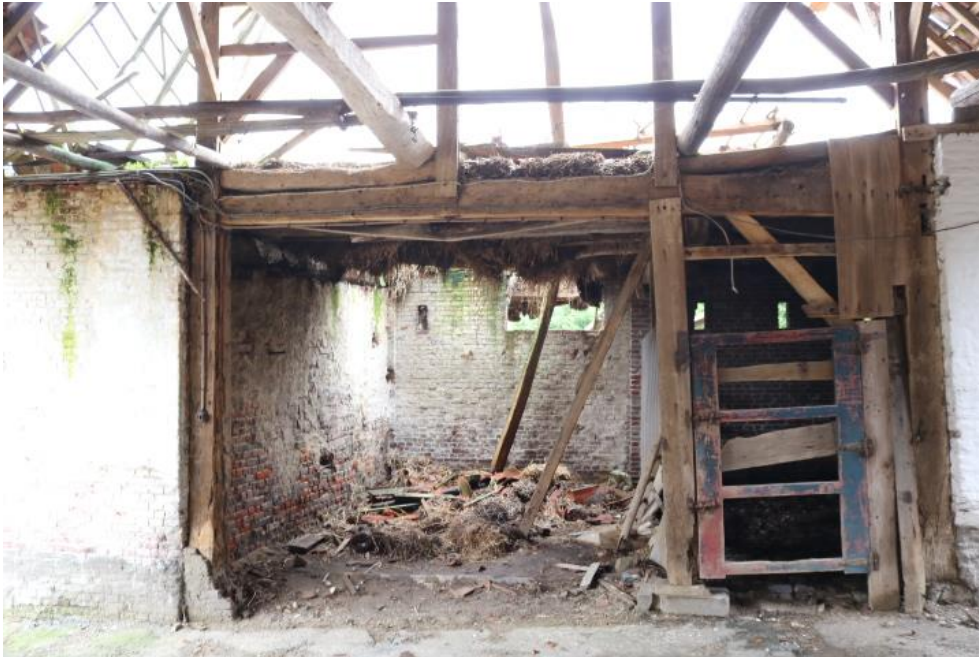
Vleugel 3 : Vervallen noordwestelijke hoek van de stalling
