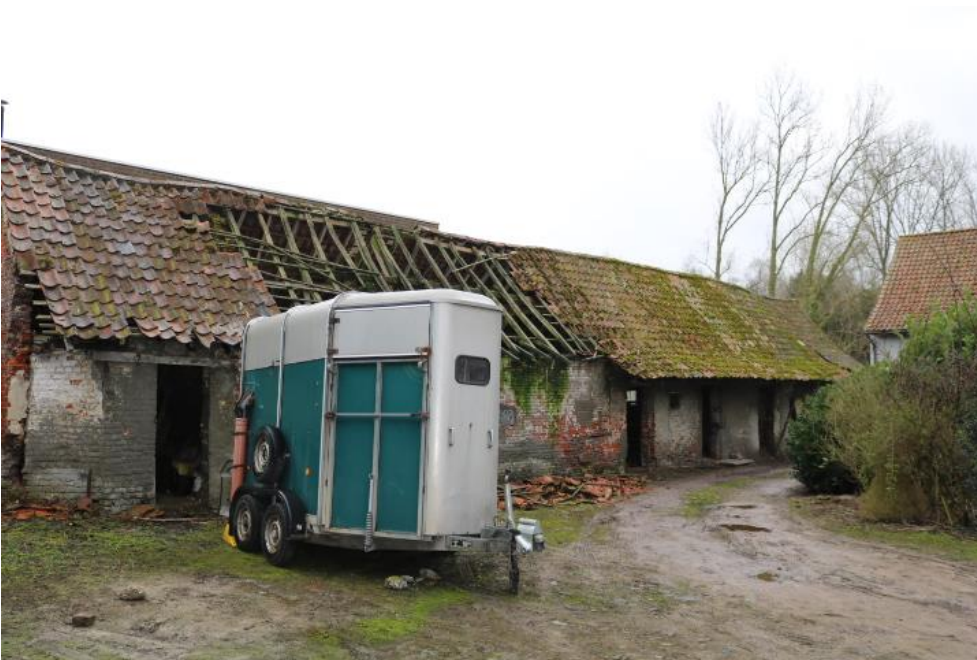
Vleugel 4 : zicht vanaf de binnenplaats. In de onderste bouwlagen werd baksteenformaat 1 vastgesteld in kruisverband
