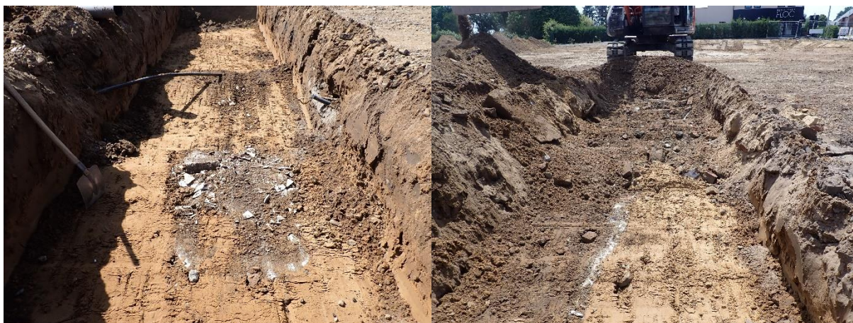
Figuur 51: Zicht op enkele recente verstoringen (© J. Verrijckt Bvba)
