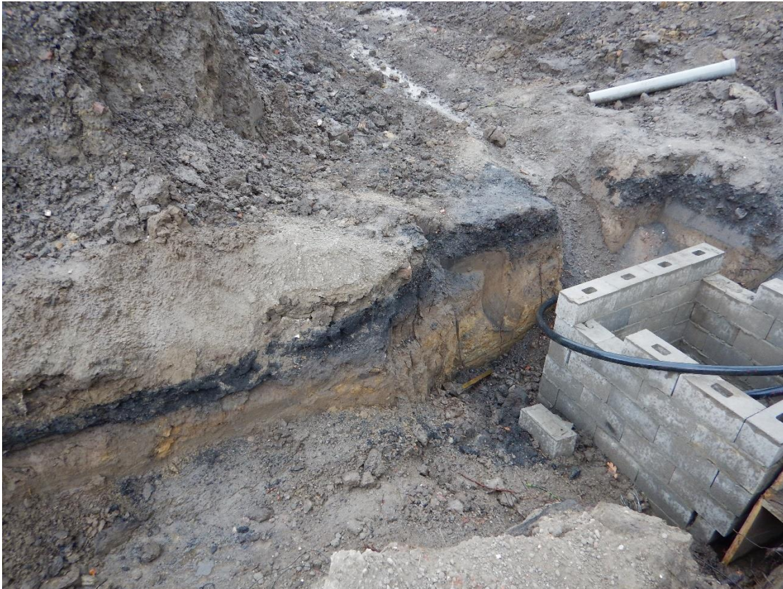
Figuur 2. Zicht op een overloopput ©ADEDE bvba.
