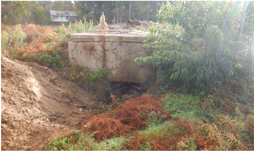
Figuur 8. De bunker voor opslag van gevaarlijke stoffen, nu overwoekerd en voor zo ver geweten gevuld met palletten. De bunker werd omwille van meerdere veiligheidsrisico's niet betreden.
