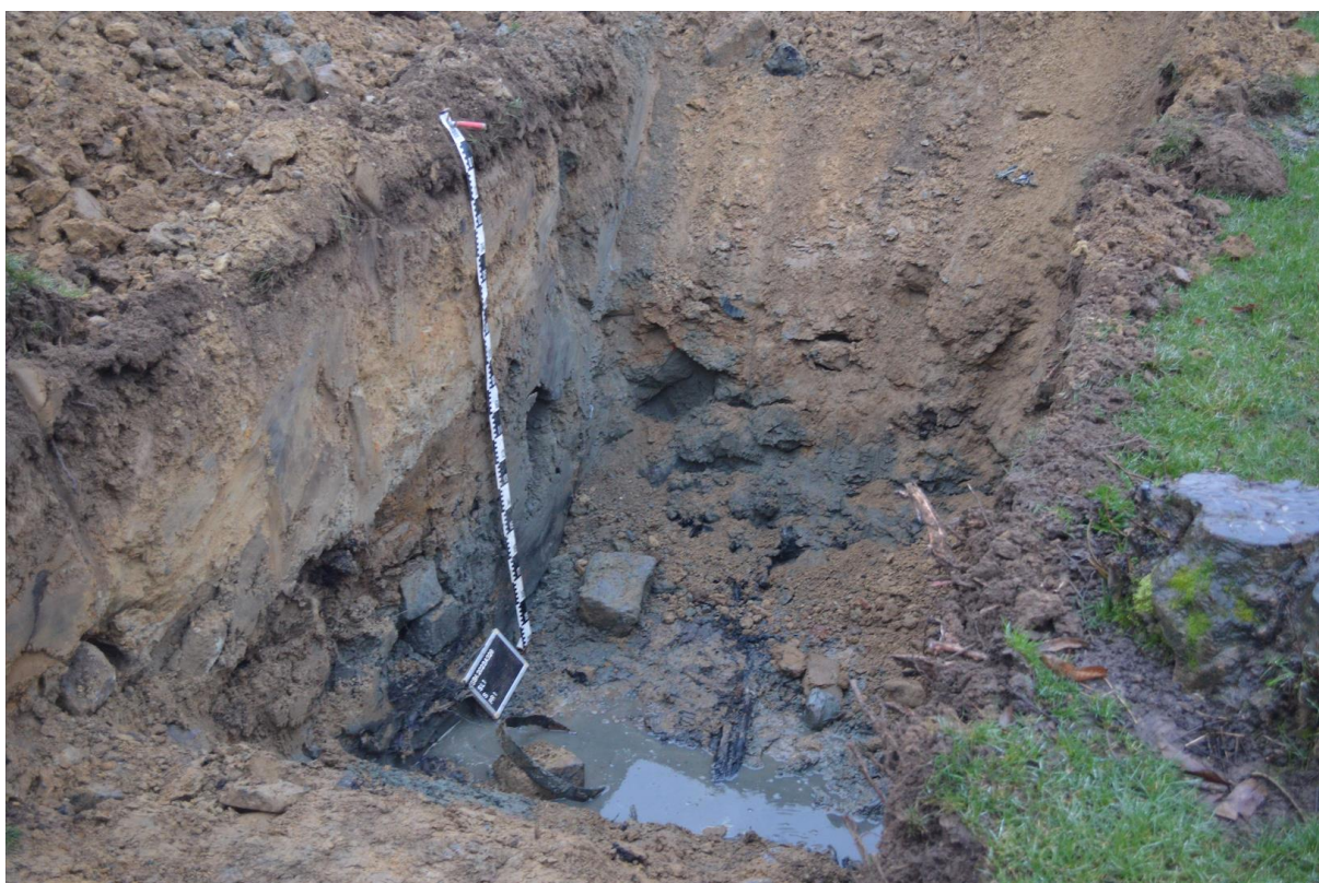
Fig. 2.6: Dik puinpakket in de bovengrond ter hoogte van proefsleuf 1, met opborrelend grondwater op ca. 200 cm onder het maaiveldniveau (= top alluviale afzettingen).
