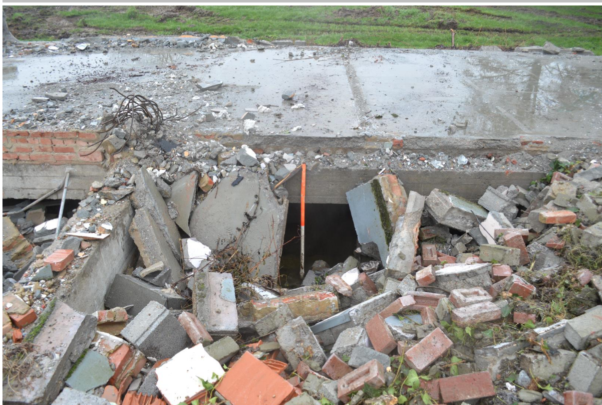
Fig. 2.5: Met een dikke betonnen vloerplaat afgedekte en met grondwater gevulde kelderruimte.
