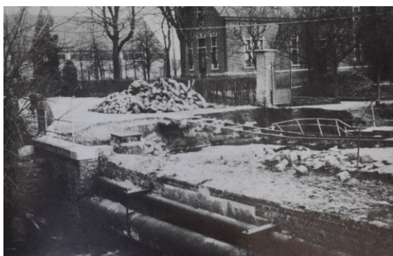
Figuur 11: Foto van de ingestorte brug over de Nete (1940).
