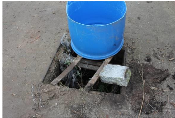
Fig. 62: Toegangspunt naar de ondergrondse leidingen.
