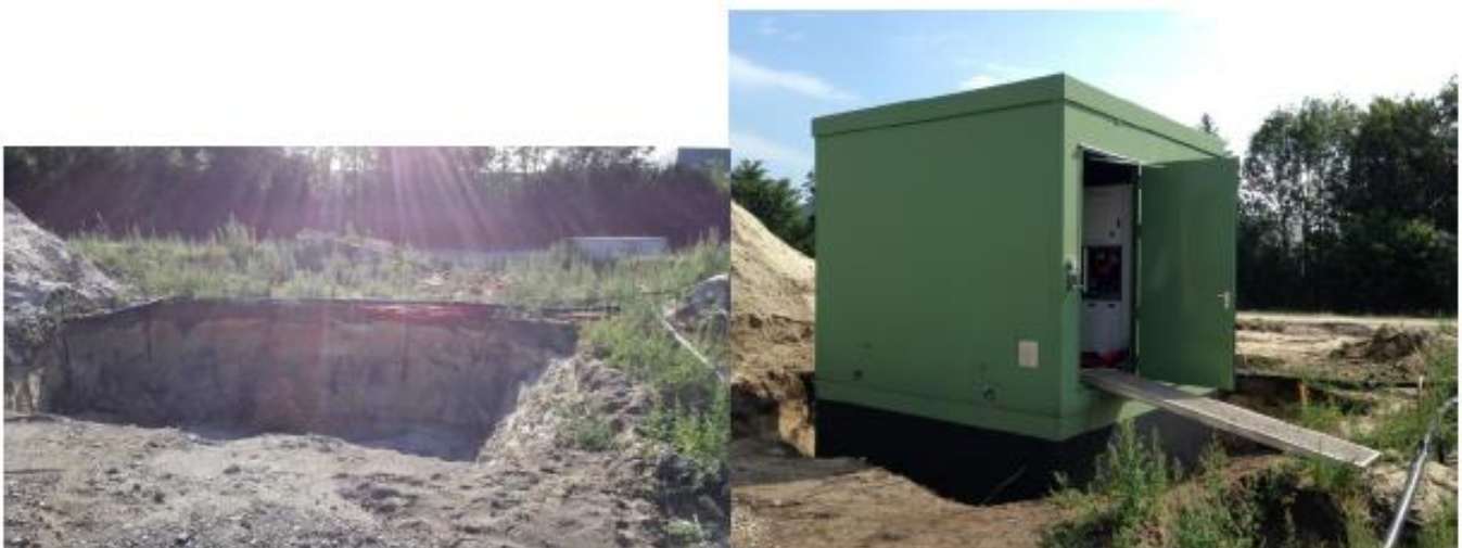
Figuur 6: Voorbeeld van netstation en elektriciteitscabine.
