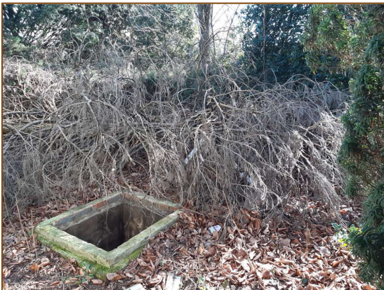
Foto 18: Ondergrondse dieseltank in achterliggende tuinzone (N naar Z)
