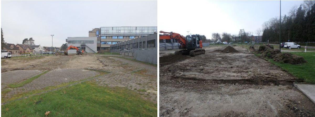
Figuur 32: Situatie voorafgaand de werken: foto richting het noorden (links); foto richting het zuiden (rechts).
