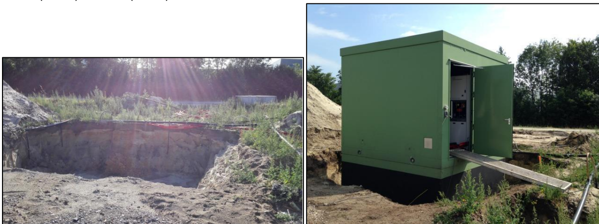
Afb. 5: Foto 3: Voorbeeld van netstation en elektriciteitscabine (project Meer) (Bron: initiatiefnemer, dd 03/01/2016, 2016L203)
