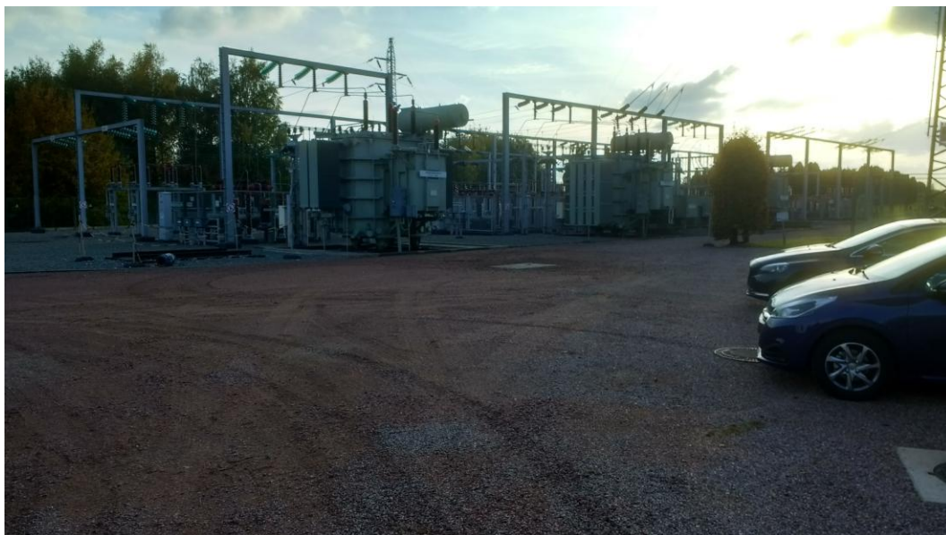
Afb. 8. Voorbeeld van huidige installatie transformator met lijnverbinding naar vakwerkconstructie.
