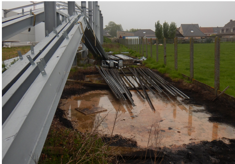
Figuur 8. Zicht op de strook grasland ten noorden van de loods in aanbouw. Onder: vervuld bluswater dat nog steeds op de site aanwezig is.
