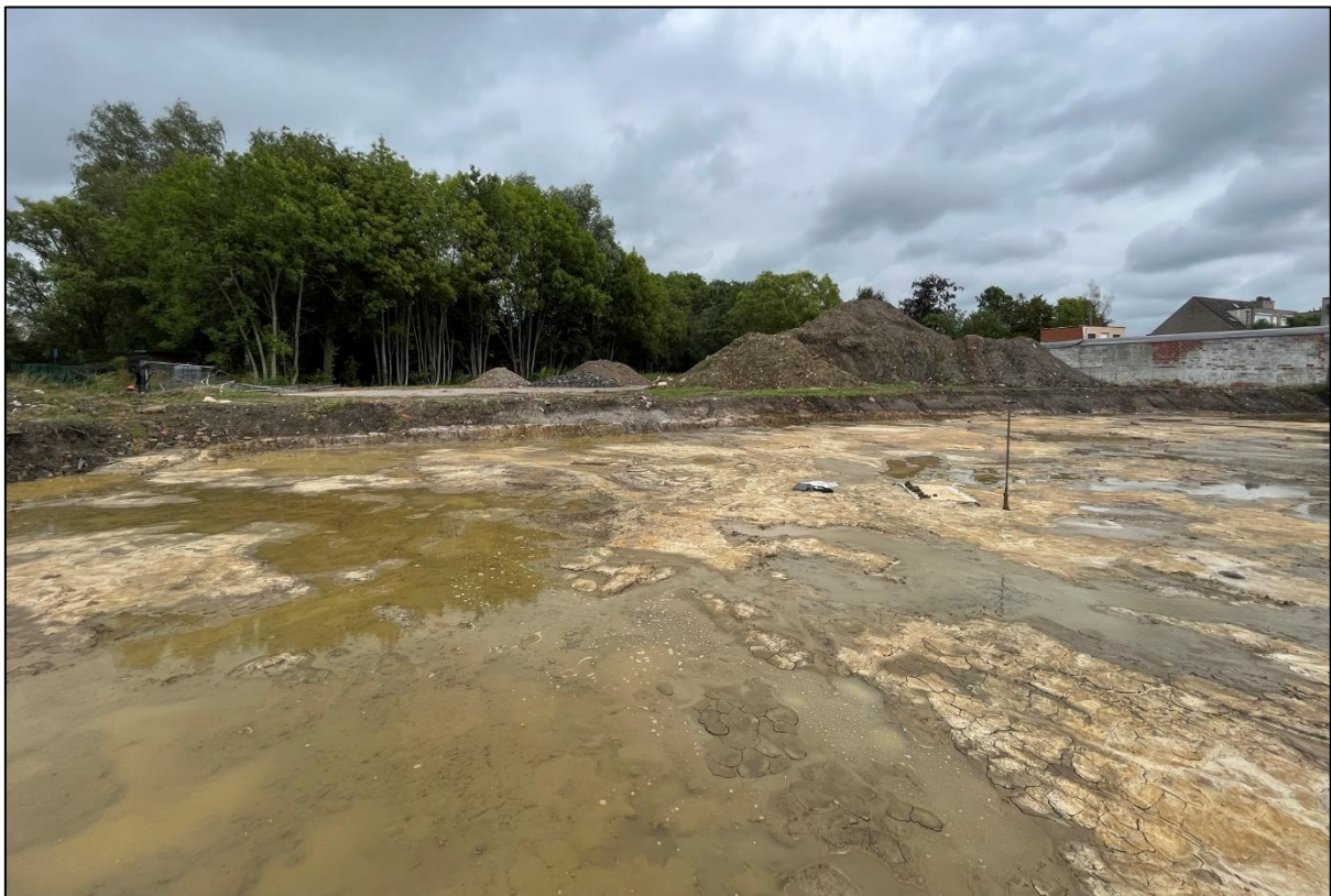
Figuur 11: De oostelijke helft van het onderzoeksgebied met centraal de uitgraving en enkele zandbergen in de verte. Gefotografeerd in noordoostelijke richting.
