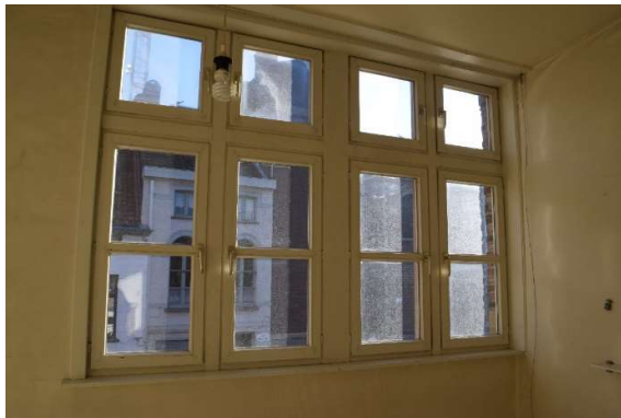
Afb. 48 Ruimte M1_R1.01: vensteropeningen ingevuld met recente ramen
