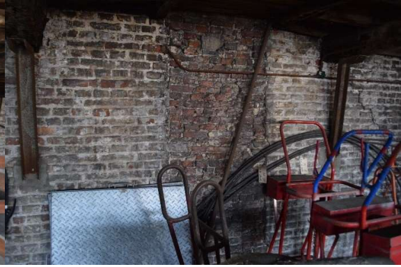
Afb. 609 M15h_R3.01: weggebroken schoorsteen
