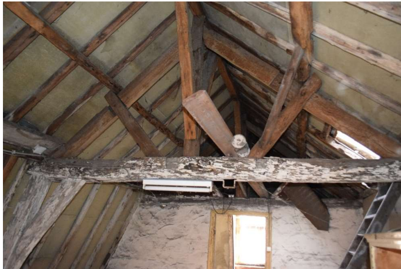
Afb. 218 Ruimte M5_R2.02: 18 de -eeuwse dakconstructie met sporen van herstellingen
