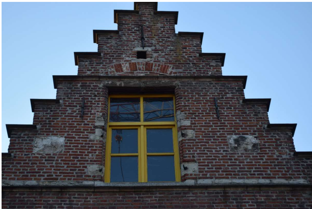
Afb. 77 M3: geveltop van de trapgevel met zoldervenster en verweerde dateringstenen
