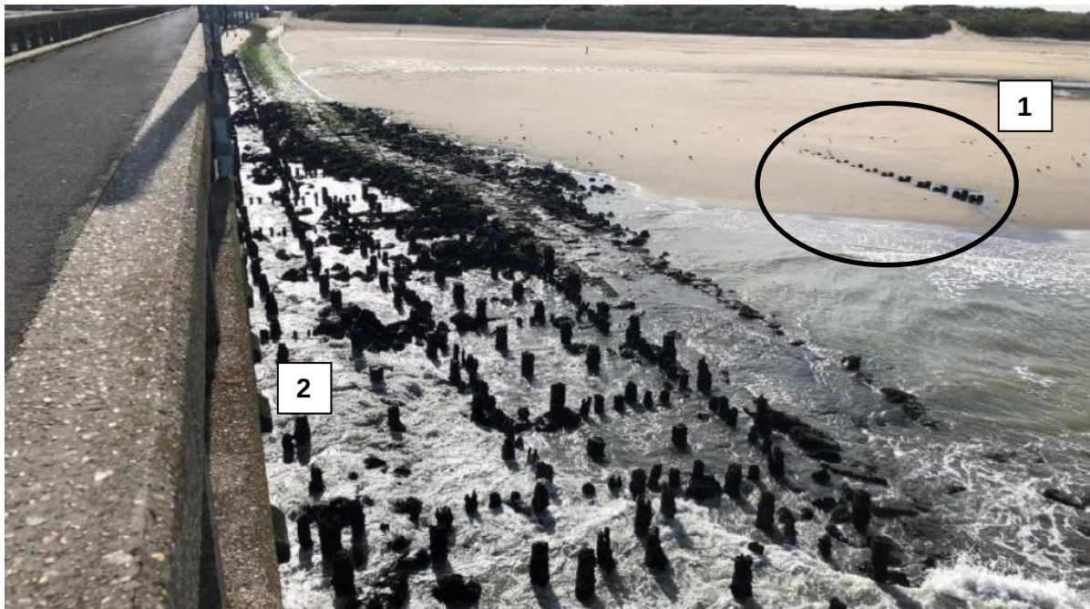
Figuur 59: Bestaande toestand van de Westdam met zicht op de aanwezige anomalieën ter hoogte van het Westerstaketsel en de Westdam. De ligging van de betonpalen op de foto rechtsboven (1) komt overeen met de locatie van de anomalie op de ferromagnetische scan van Braet NV en betreft geen archeologische structuur. De palencluster op de voorgrond (2) gaat mogelijk terug op een oudere constructie (wierdijk?, voorloper Westerstaketsel) (© Braet NV, opdrachtgever).
