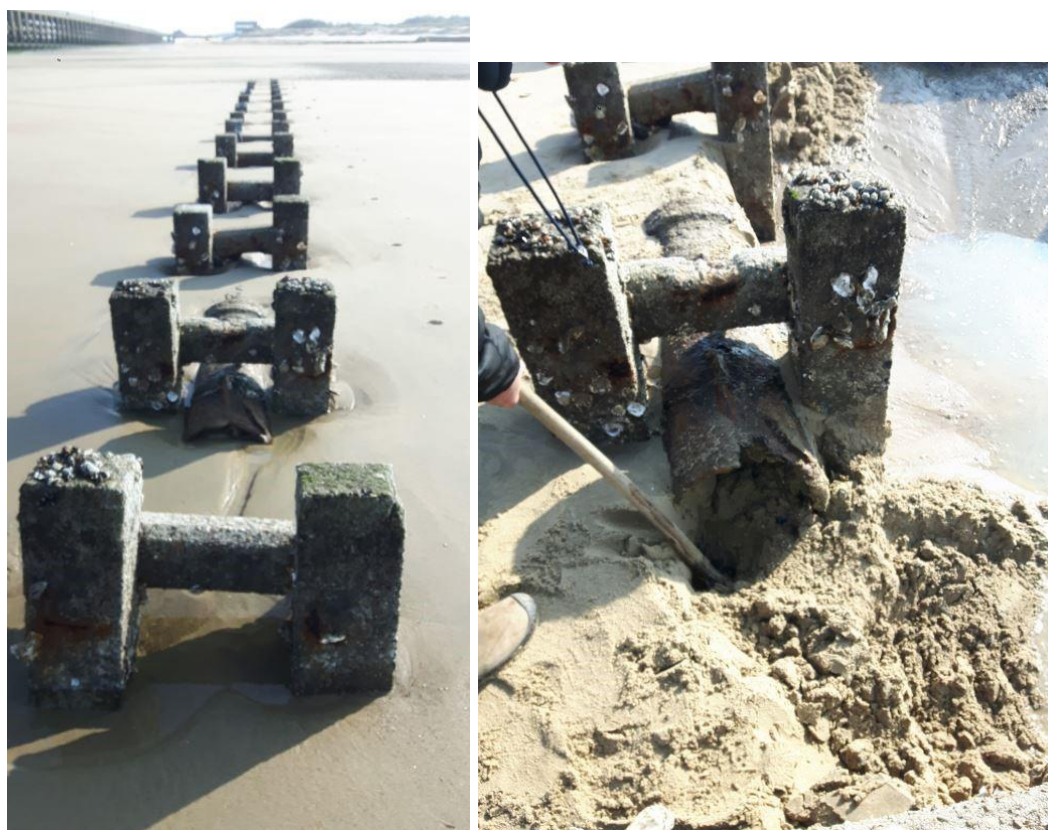
Figuur 61: zicht op de verbuisde leiding tussen een beschermingsconstructie bestaande uit betonpalen. Deze kon gevolgd worden over een afstand van minstens 340 m (© initiatiefnemer).
