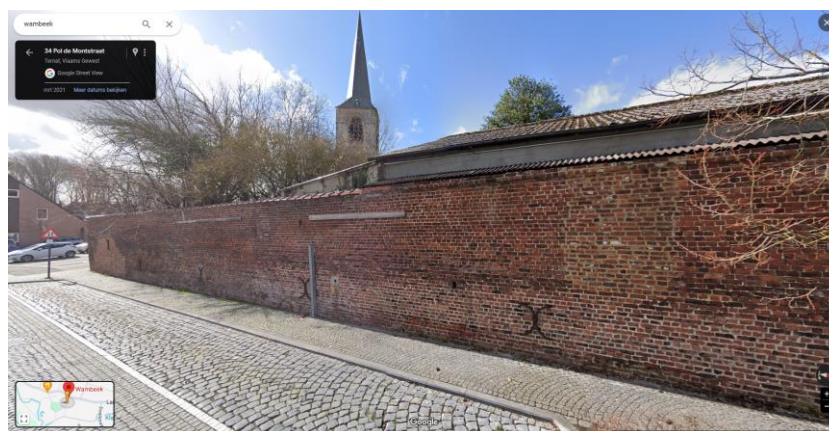
Figuur 5: Zicht op de muur vanuit de Pol de Montstraat (© Google Streetview, mei 2021)
