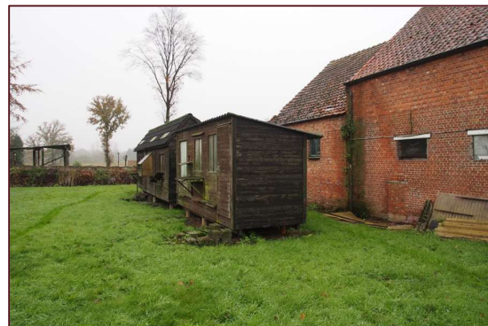
Foto 10: Nr. 58, tuin met zicht op niet gefundeerde duivenkoten. Gevel O van nr. 56 (bron: AIR)
