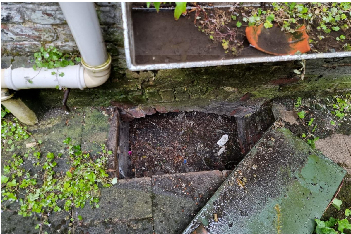
Figuur 1. Keldergat t.h.v. Heldenlaan 44, ter illustratie.
