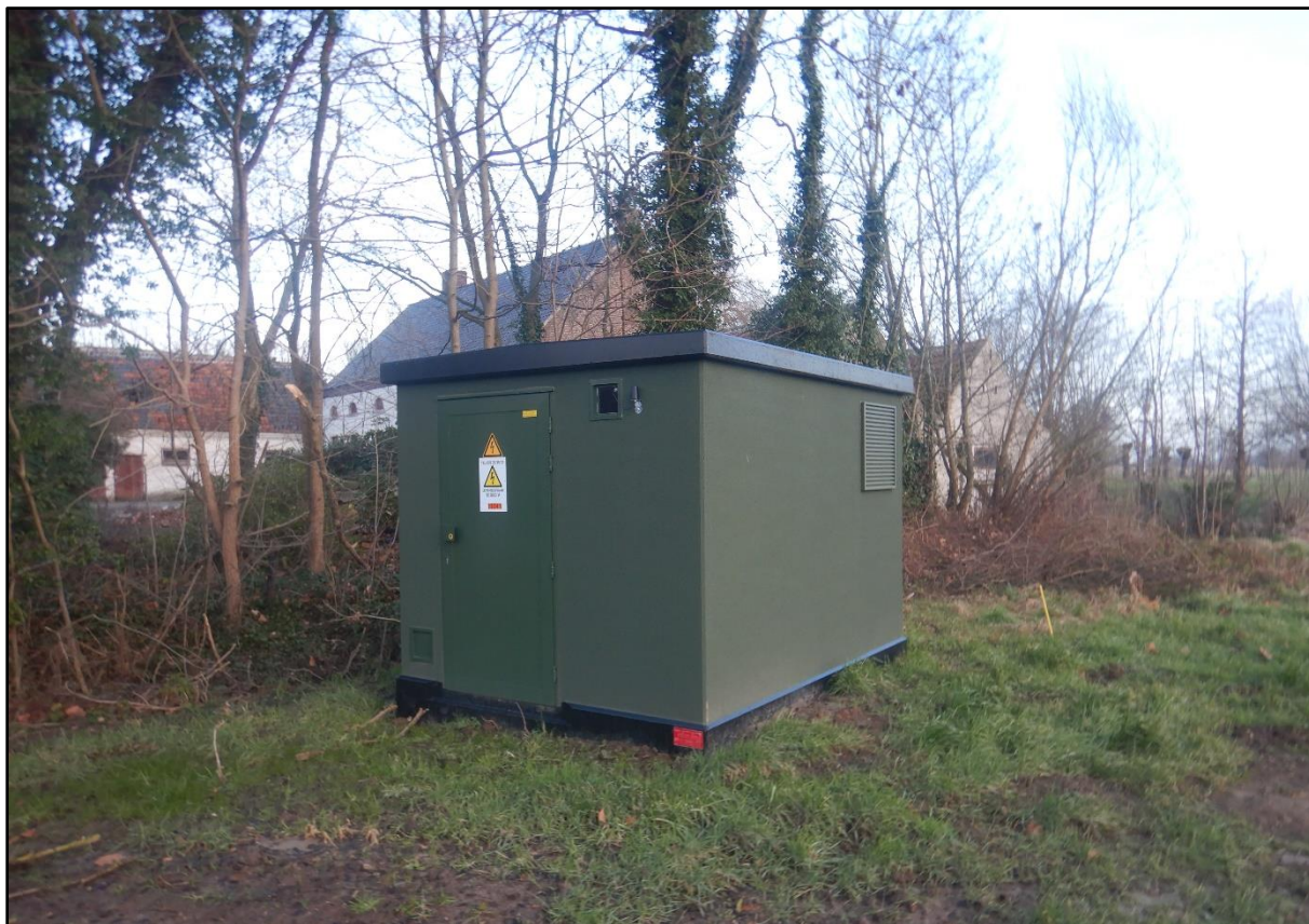
Figuur 2 Zicht op de elektriciteitscabine in het zuidwesten van de noordwestelijke advieszone.
