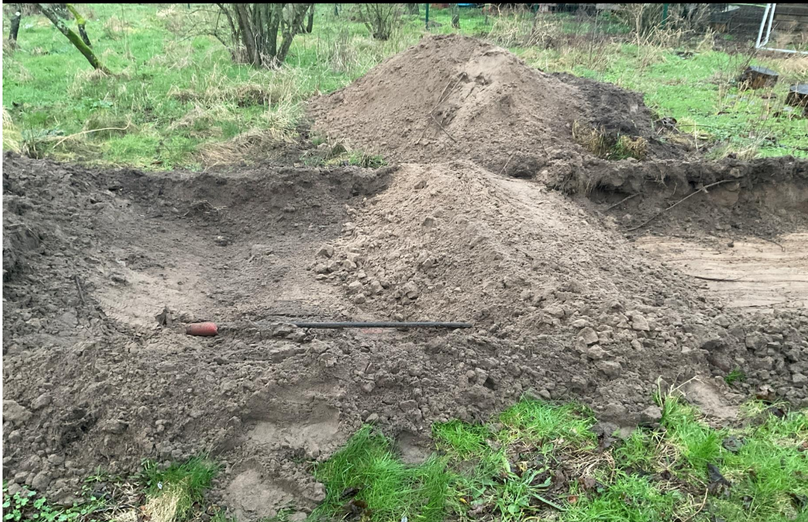
Figuur 17: Fotoreportage WP2 toont de aangetroffen bekabeling gerelateerd aan zonnepanelen aanwezig op tuinberging op perceel 836b
