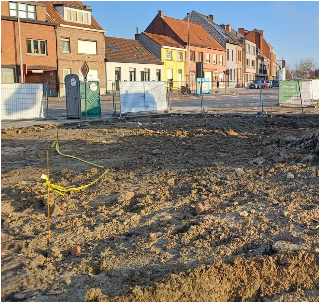
Figuur 6: Deel van de zone met asbest
