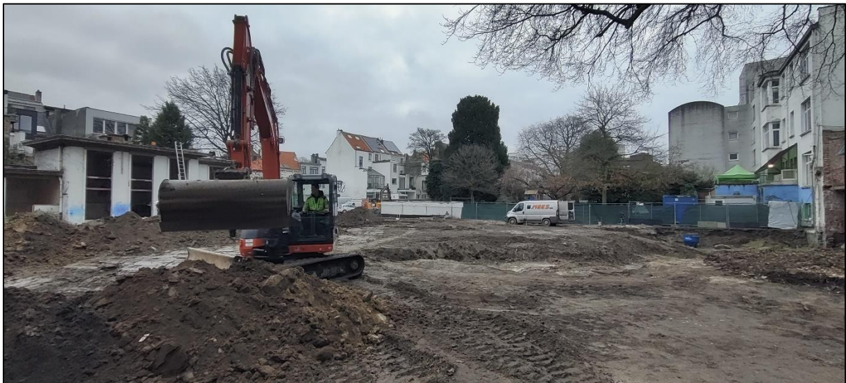
Figuur 8: Overzichtsfoto van de situatie op het terrein met aanwezige bebouwing, afgezette speelplaats en werfweg en open kelderzone.
