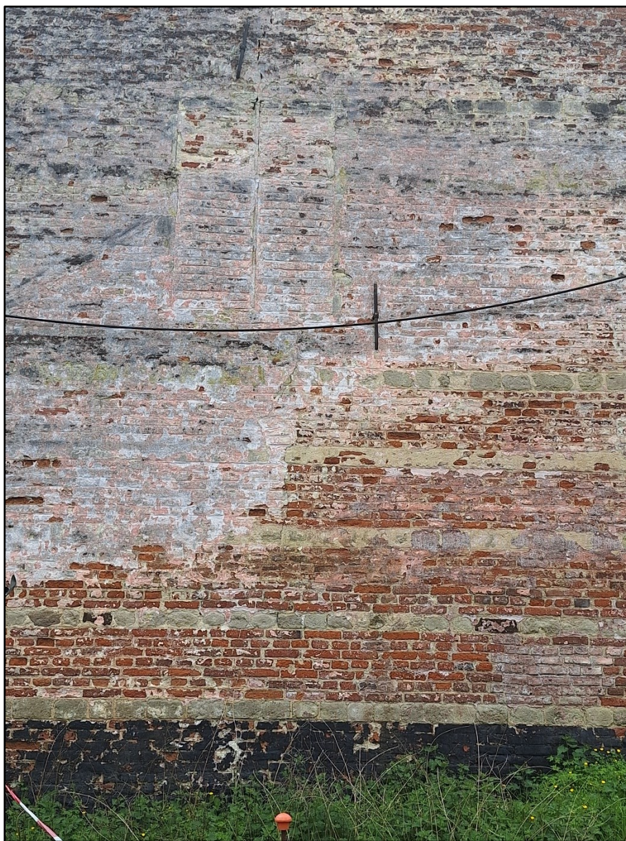
Figuur 73: Detail natuurstenen speklagen en dichtgemetseld kruisvenster (ABO nv 2024)
