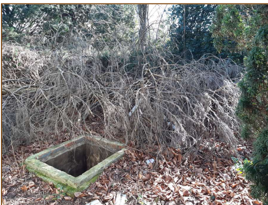
Foto 18: Ondergrondse dieseltank in achterliggende tuinzone (N naar Z)
