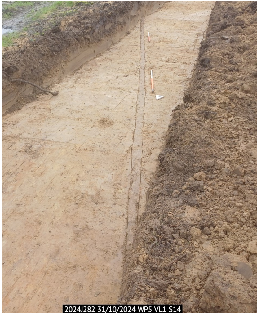
Figuur 43: Drainagebuis S14
