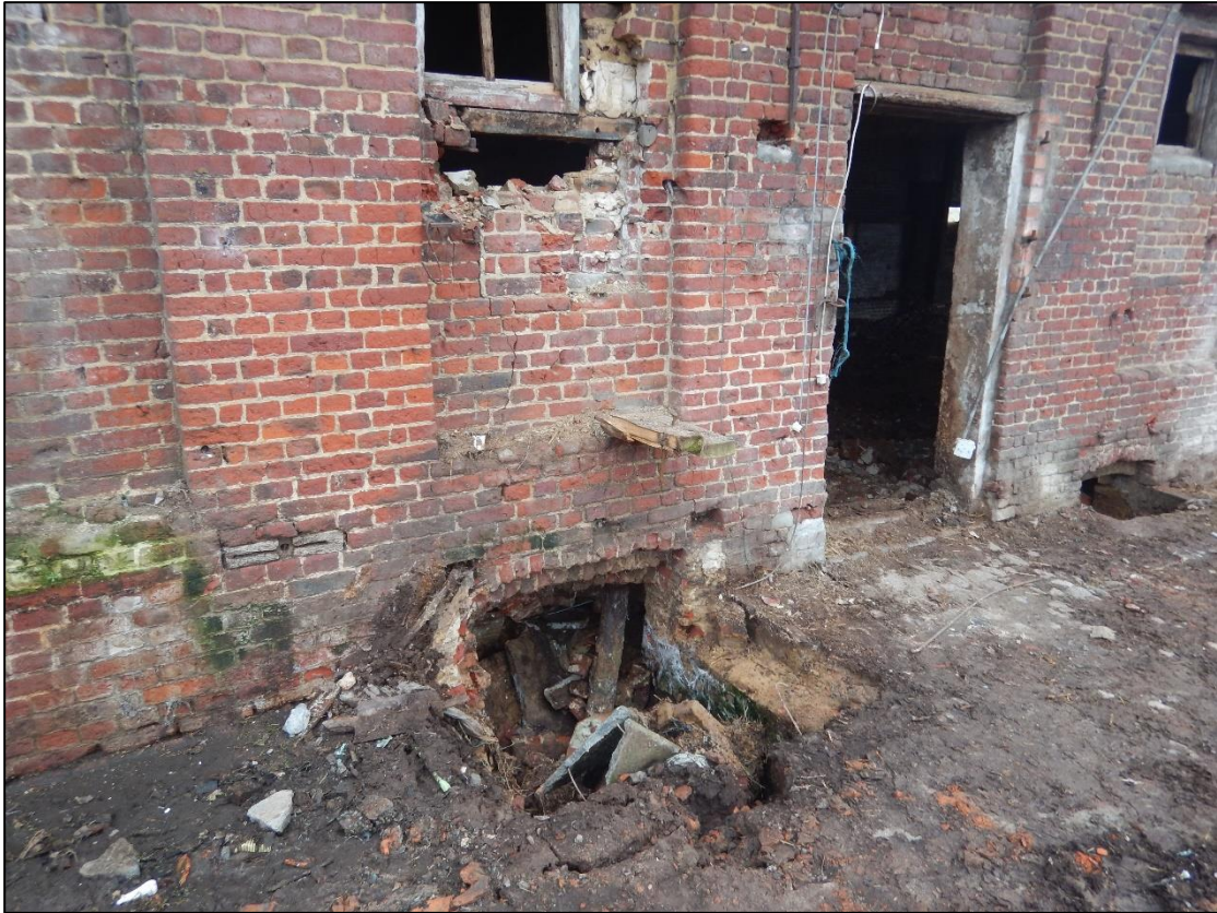
Figuur 16: Zicht op de locatie van de niet aangelegde proefput. Er zijn openingen naar vermoedelijk voormalige mestkelders (?) te zien met ertussen betonnen verharding.
