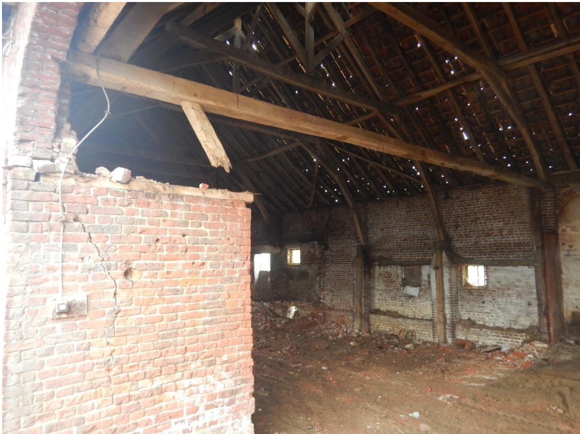
Figuur 15: Binnenzicht aan de noordzijde van de schuur met op de voorgrond een scheur in het muurwerk.
