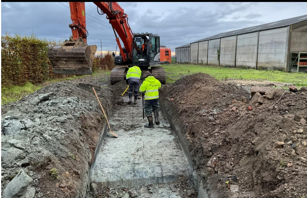
Figuur 30: fotografische opname van de aanleg van een proefsleuf naast de aanwezige loods.
