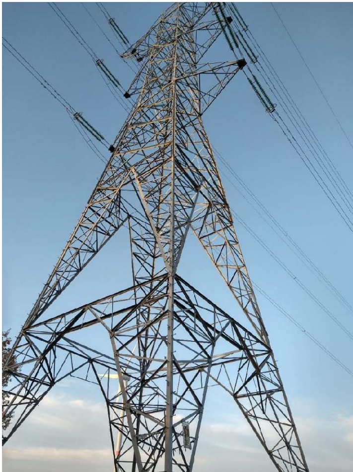
Figuur 7. Hoogspanningsmast naast boring 5. ©LARES
