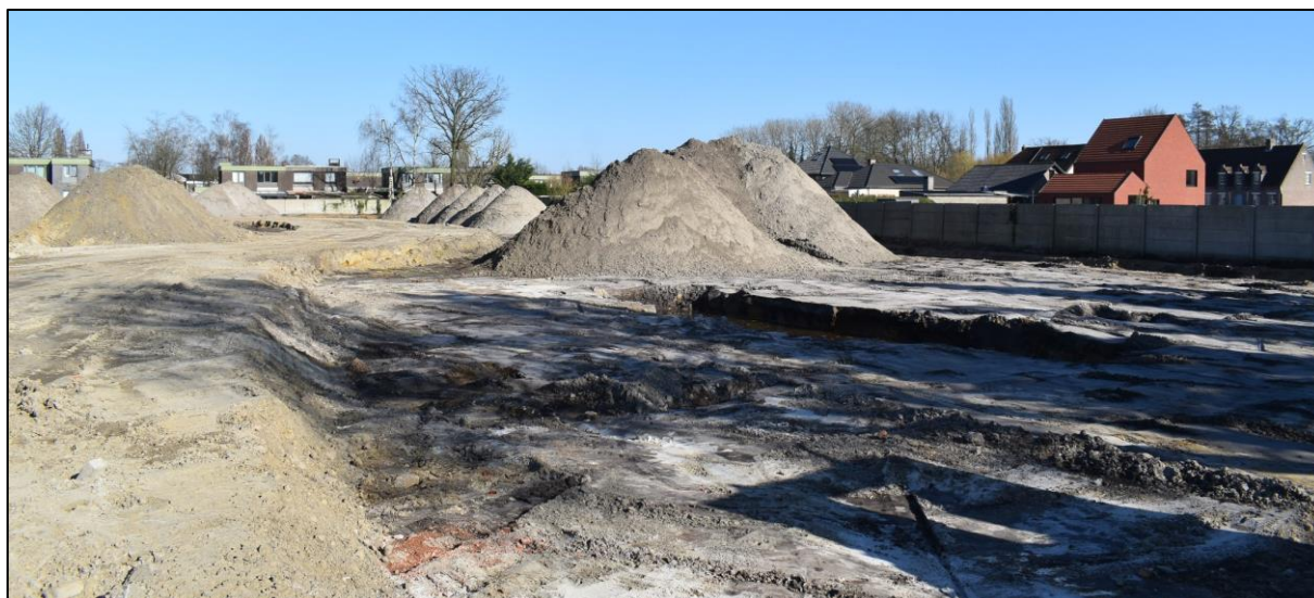
Afb. 22: Zicht op werfwegenis, grondhopen, afgegraven niveau en een diepere verstoring in het zuidwesten van het terrein, foto genomen vanuit de westelijke toegangspoort (Bron: ARON bv, dd. 6/03/2025, 2025C46).
