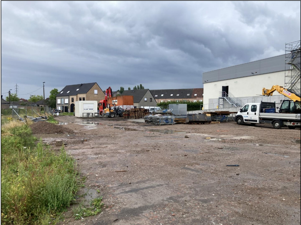
Figuur 7: Toestand van het terrein ter hoogte van fase 2 getrokken in zuidelijke richting. Achteraan is de actieve werf van fase 1 zichtbaar.
