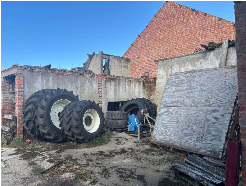
Figuur 6: Zicht op de ingestorte loods. 8
