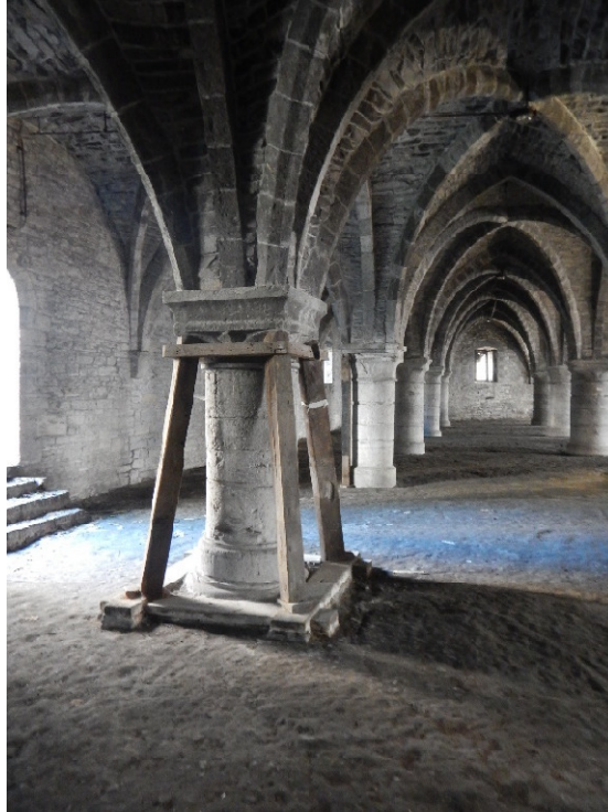
Figuur 9. De gestutte pijler tijdens de begeleiding van de sonderingsputten in juni 2020.
