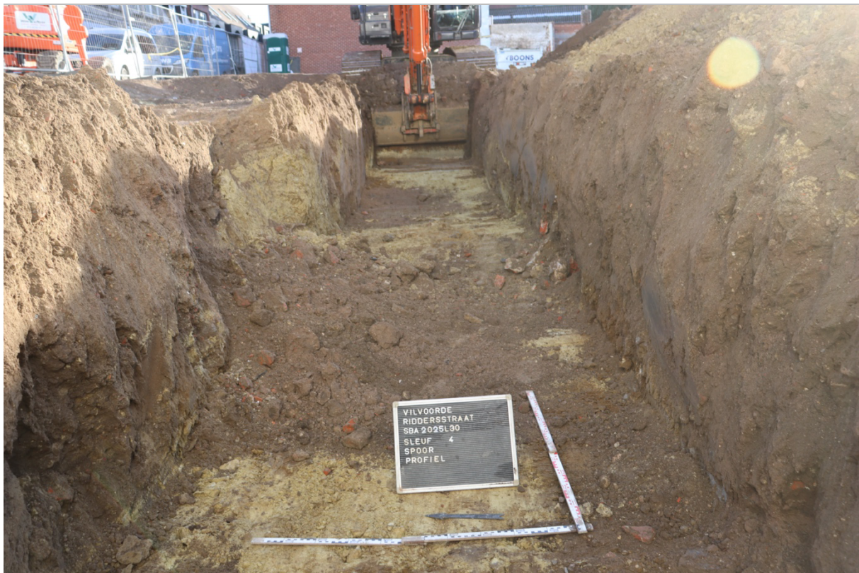
Fig. 2.9: Ingestorte sleufwand in proefsleuf 4
