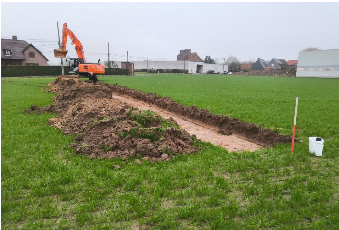
Figuur 24 Zicht op het plangebied voorafgaand het proefsleuvenonderzoek. Foto genomen vanuit het noordwesten.
