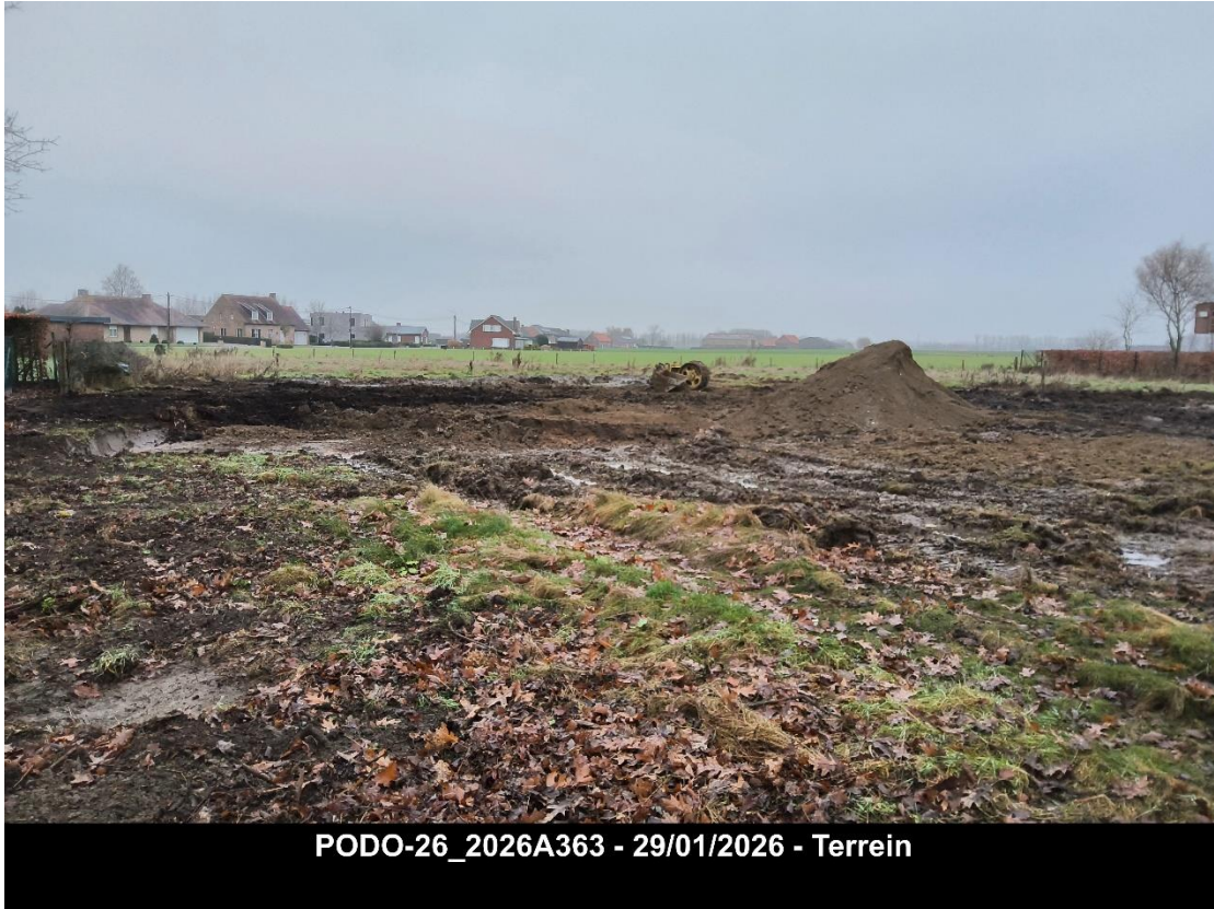
Figuur 9: zicht op het noordwestelijk deel van het projectgebied, voor aanvang van de werken.
