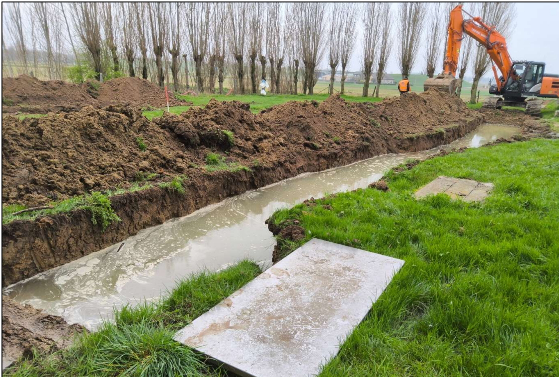
Figuur 10: Lekkende regenputten naast sleuf 6.
