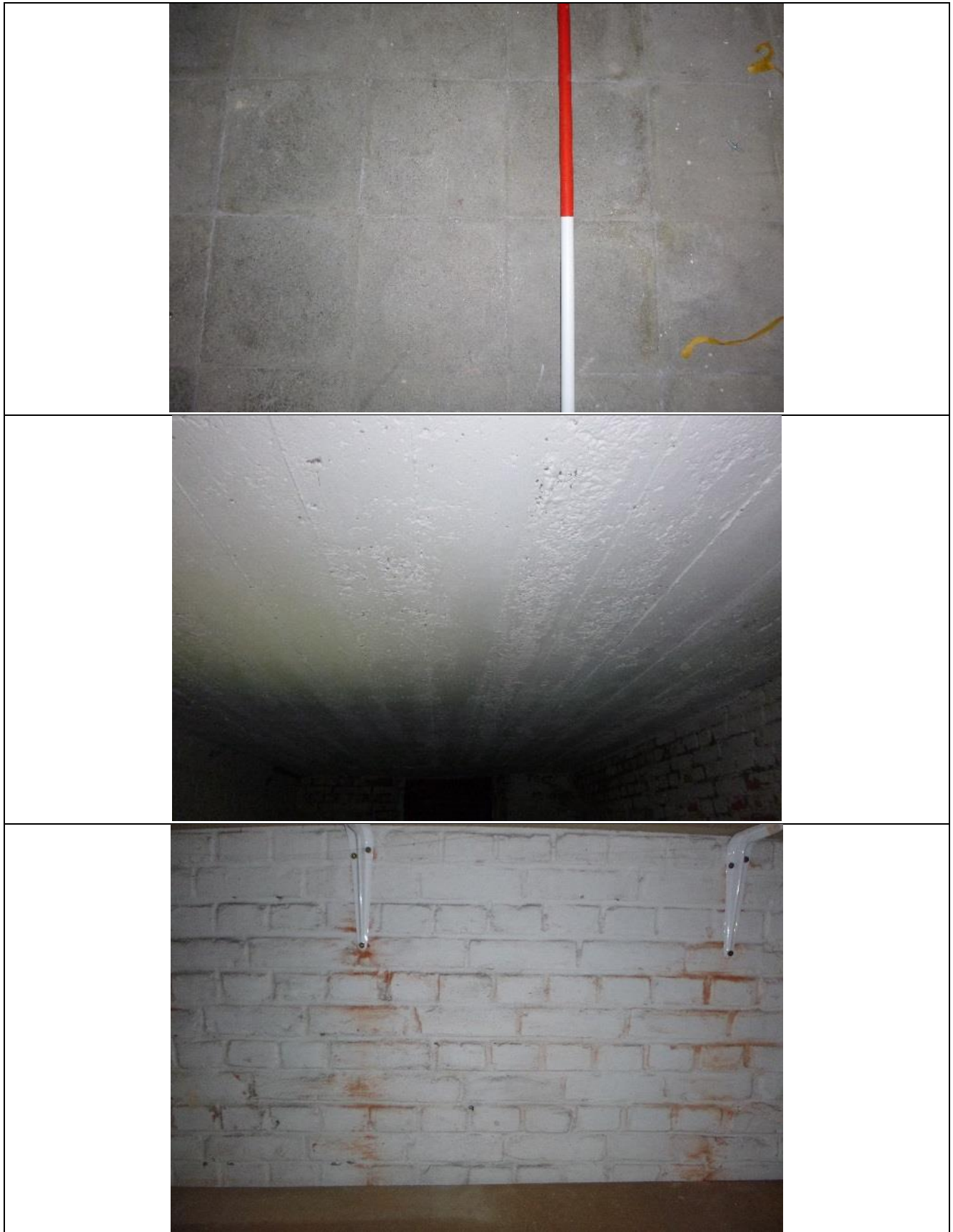
Figuur 10: Foto's van de muren, plafond, vloer en metselwerk van kelder 2
