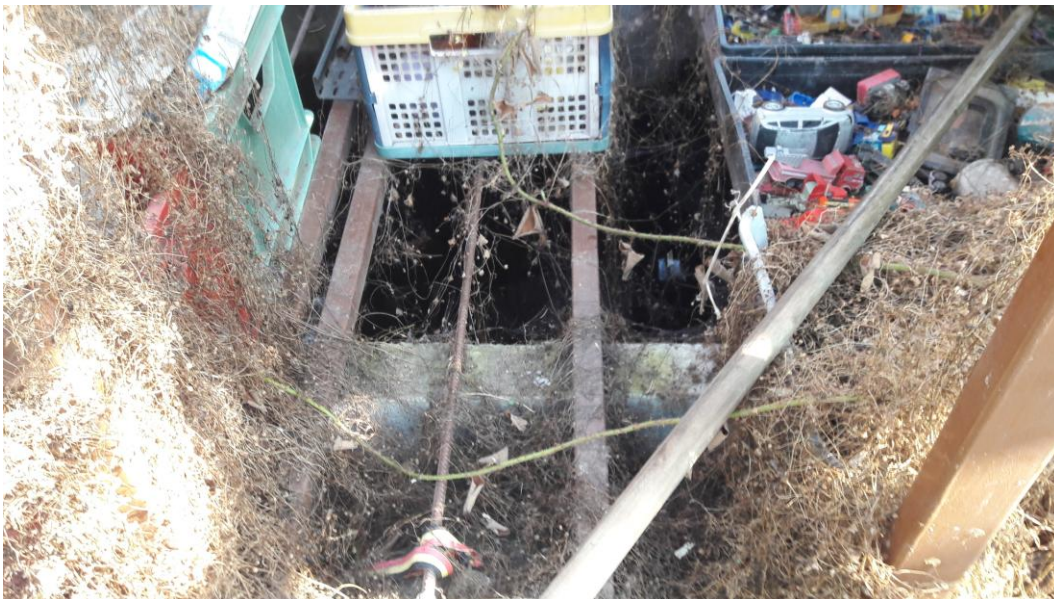
Afb. 11. Waterput in een serre. 3
