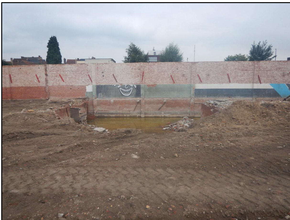
Foto 2: Zicht op verstoring door een kelder langs de westelijke wand van het plangebied. Hier diende sleuf 10 onderbroken te worden.
