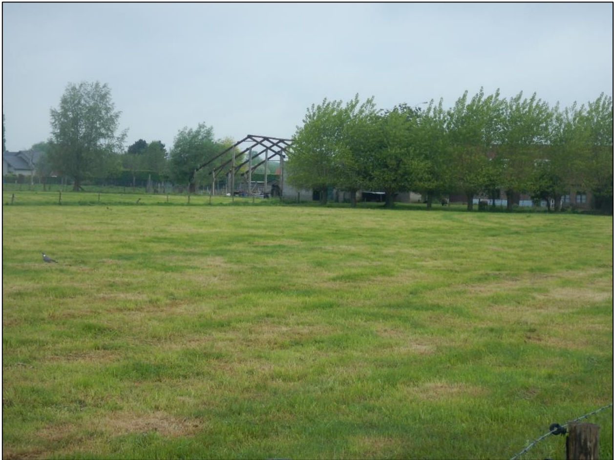
Figuur 15: Zicht op de deels afgebroken schuur/loods (foto genomen op 3 mei 2017).
