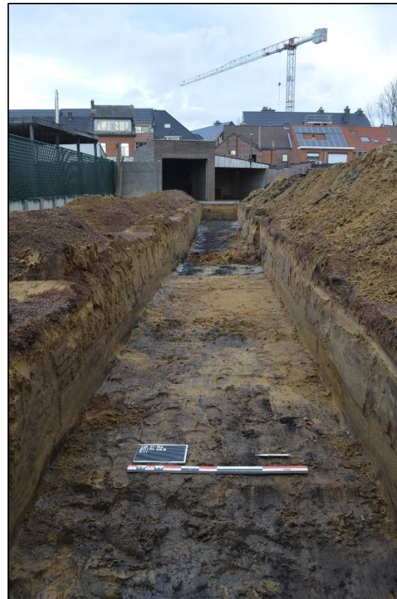
Afb. 11: Deels ingestorte sleufwanden
