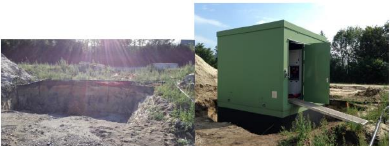
Figuur 7: Voorbeeld van netstation en elektriciteitskabine.
