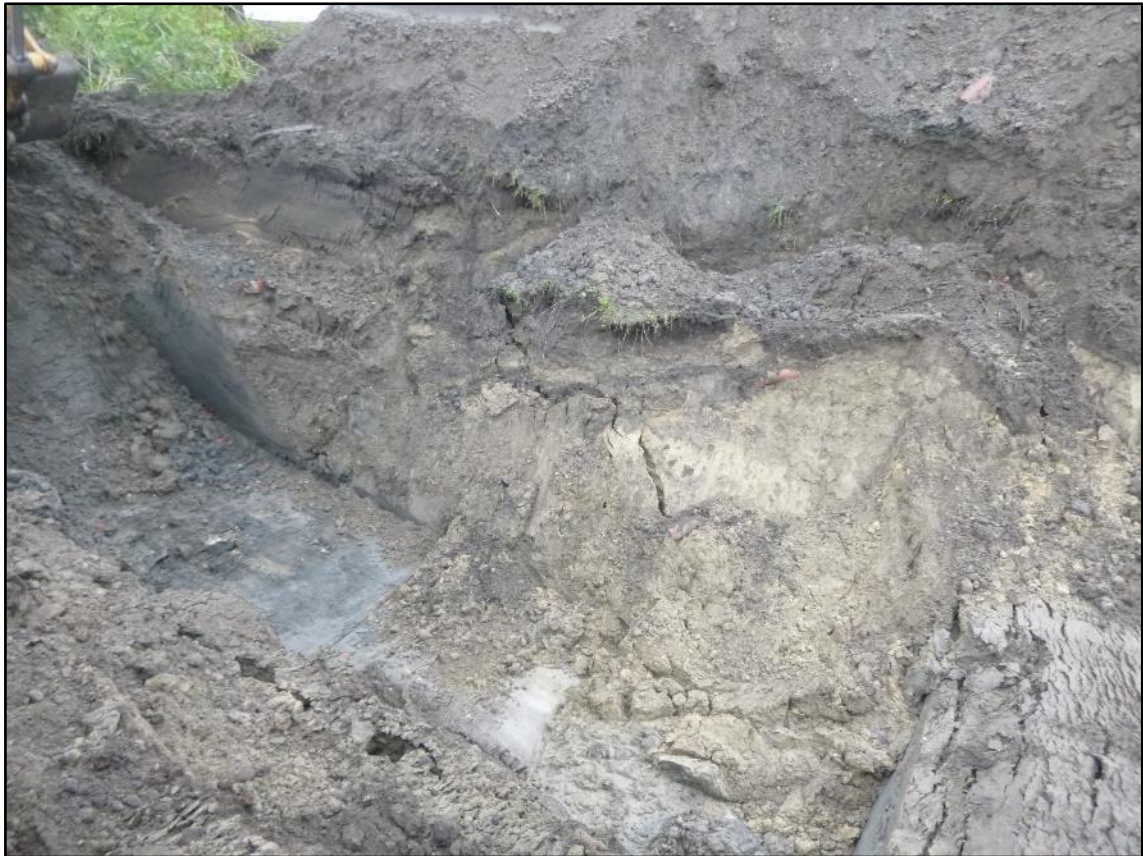
Figuur 39: Onveilige situatie tijdens het aanleggen van Werkput 1
