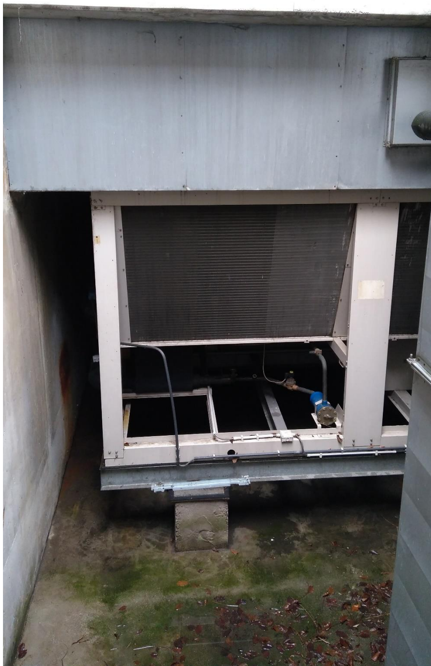
Figuur 43: Zicht binnen de ondergrondse technische ruimte
